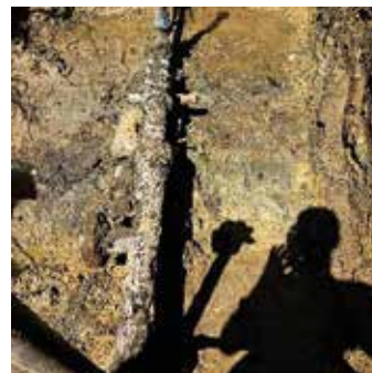
Alte Wasserleitung, die stillgelegt wurde
